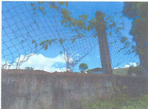
Foto 3: Necesidad mejoramiento muro perimetral
