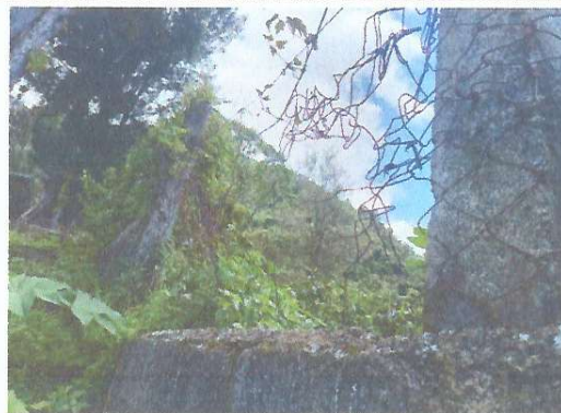
Foto 4: Necesidad mejoramiento muro perimetral
