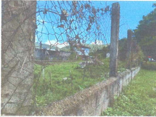
Foto 1: Necesidad mejoramiento muro perimetral
