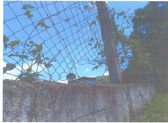
Foto 2: Necesidad mejoramiento muro perimetral
